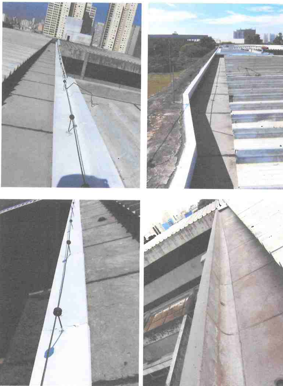
Fotos 1, 2, 3 e 4 – Calhas Impermeabilizadas no Prédio do Complexo Judiciário Mario Guimarães.
